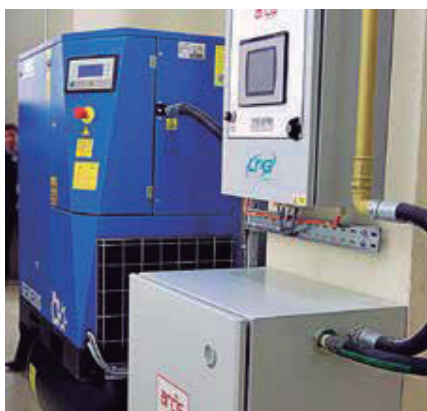
↘ Sistema de redução de ar (compressor, módulo de ar hipóxico e unidade de controlo).
