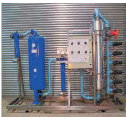
↳ Exemplo de uma instalação do sistema de redução de oxigénio.
